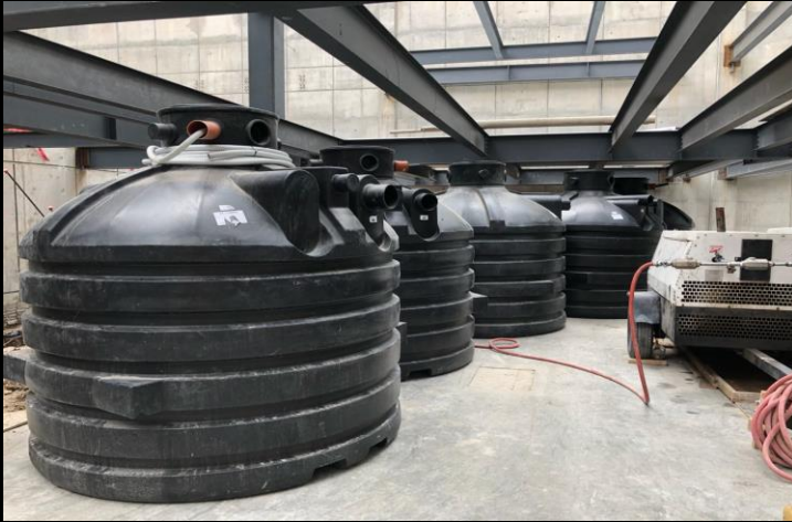
Planta de tratamiento de aguas residuales
