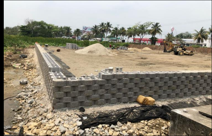
Muro de contención modular, Tabasco
